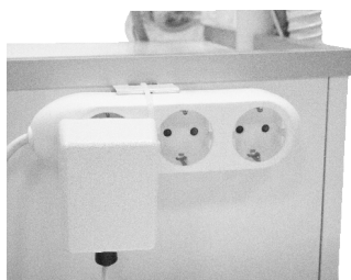
Grenkontakt med transformator
